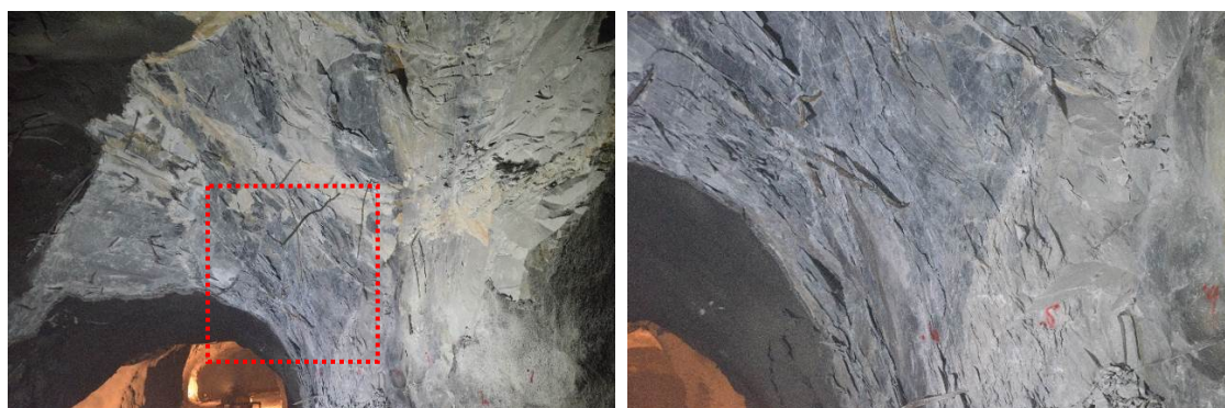
(b) 7#实验室 K0+012 北侧拱肩~边墙（边墙扩挖，右图为左图虚线框的局部放大图）
