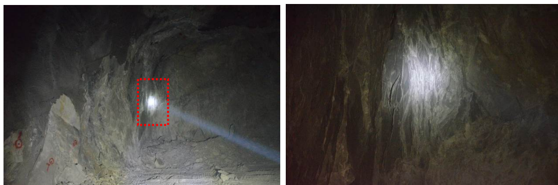
(a) 8#实验室 K0+058 北侧边墙（中导洞开挖，右图为左图虚线框的局部放大图）
